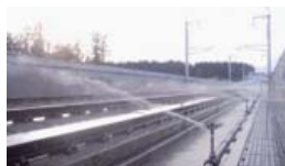
散水消雪設備（東北新幹線）
