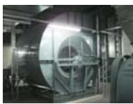
トンネル換気機械室（つくばエクスプレス）
