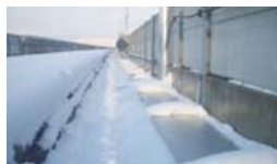
温水パネル融雪設備（北陸新幹線）
